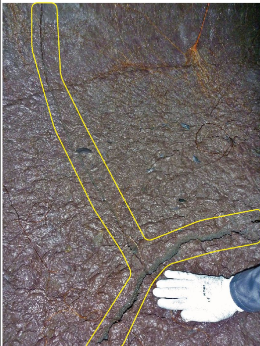
Illustration 22: Fractures liées au tassement de la coulée
